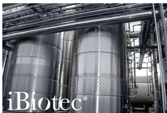
Lavaggio di serbatoi di produzione inter batches
